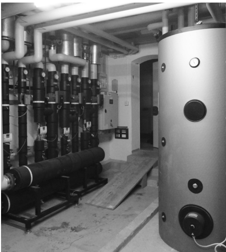
Neue Heizverteileranlage mit Warmwasserboiler
